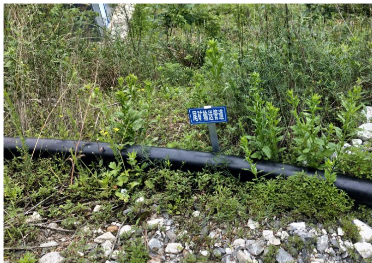
图 4.1.1-3 尾砂管道运输
