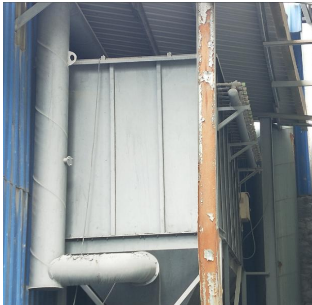
图 4.1.1-1 破碎工段布袋收尘设施
